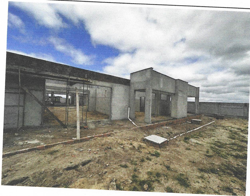
FOTO 75: CAIXAS DE INSPEÇÃO PLUVIAL
