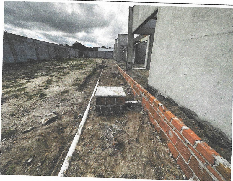
FOTO 72: CAIXAS DE INSPENÇÃO SANITÁRIA
