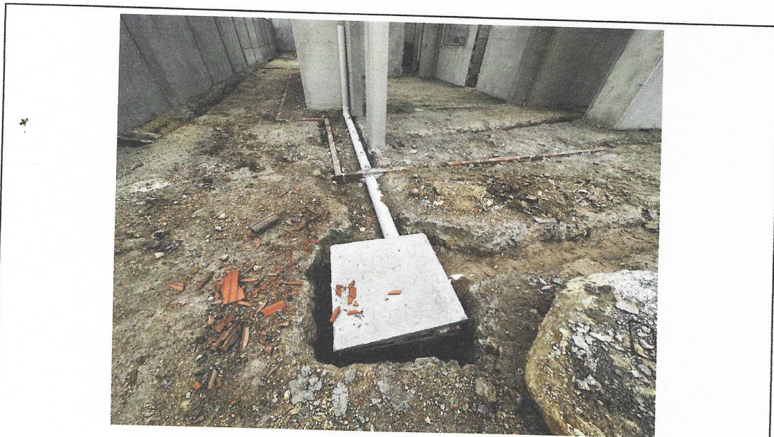
FOTO 74: CAIXA DE INSPENSÃO PLUVIAL
