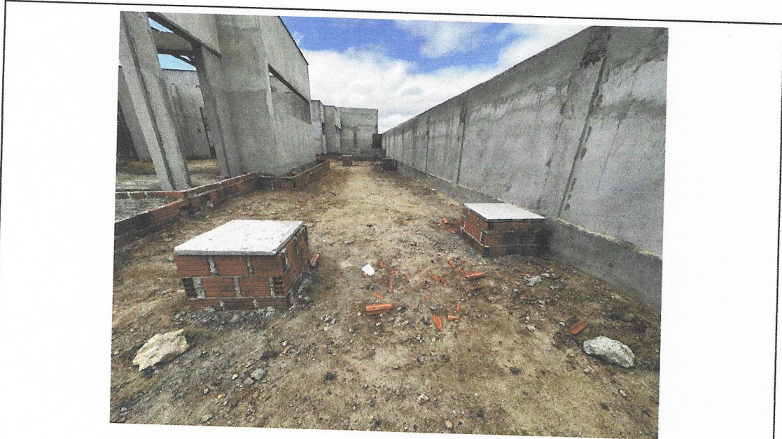
FOTO 73: CAIXAS DE INSPEÇÃO SANITÁRIA
